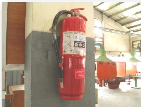
รูปที่ 1.11 แสดงอุปกรณ์ถังดับเพลิงต้องพร้อมใช้งาน
