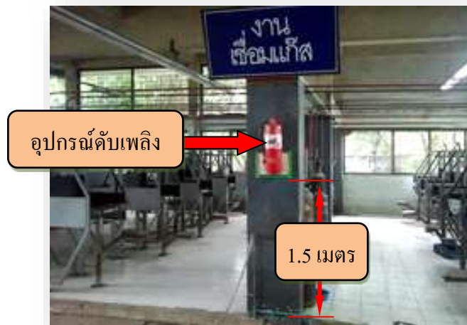
รูปที่ 2.3 แสดงการติดตั้งอุปกรณ์ดับเพลิงไม่เกิน 1.5 เมตร
