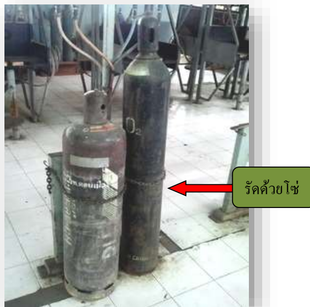
รูปที่ 2.38 แสดงการวางถังแก๊สแล้วรัดด้วยโซ่ให้แน่น
