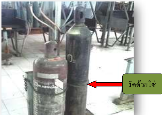
รูปที่ 2.51 แสดงการวางถังแก๊สแล้วรัดด้วยโซ่
