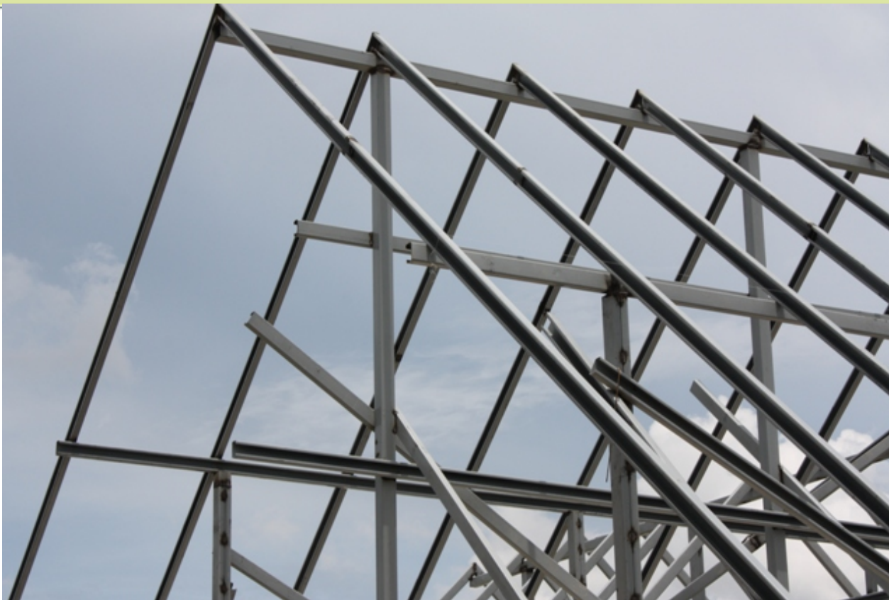
ภาพที่ 9.13 เหล็กโครงสร้าง
