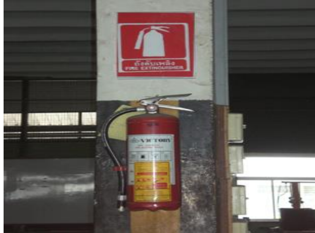
รูปที่ 4.5 แสดงจุดที่ติดตั้งอุปกรณ์ดับเพลิงที่มองเห็นได้ชัดและหยิบใช้ได้ง่าย ที่มา : ชลอ ประยูรพันธ์ : 2557
