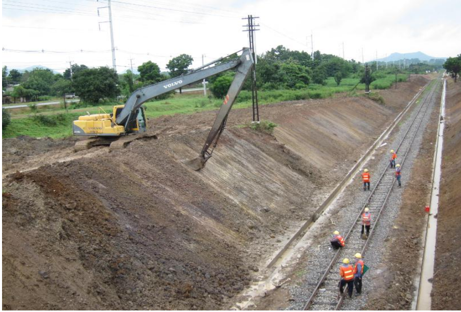
รูปที่ 7-17 การปรับแต่งลาดทางตัดด้วยรถแบ็คโฮและติดตั้งรางระบายน้ำ คสล. ข้างทาง
