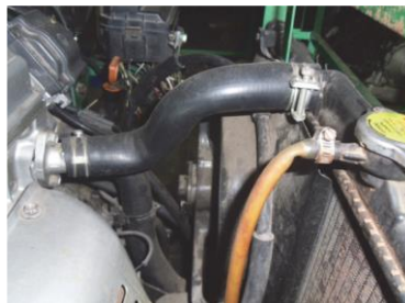
ครีบน้ำร้อนเสียรูป
