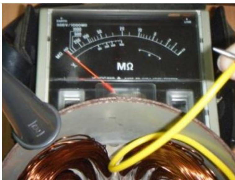
รูปที่ 4.7 ใช้เมกเกอร์ตรวจสอบการกราวด์มอเตอร์
